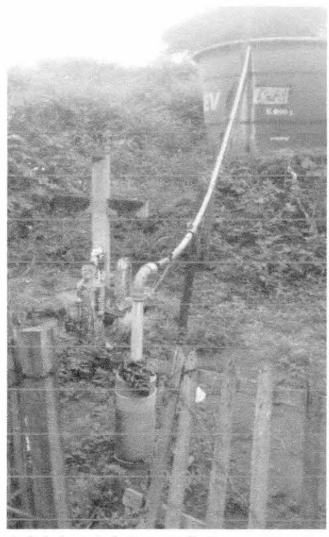
POÇO PROFUNDO EXISTENTE
